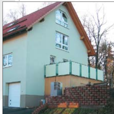
Aria/acqua esterna 7 kW
